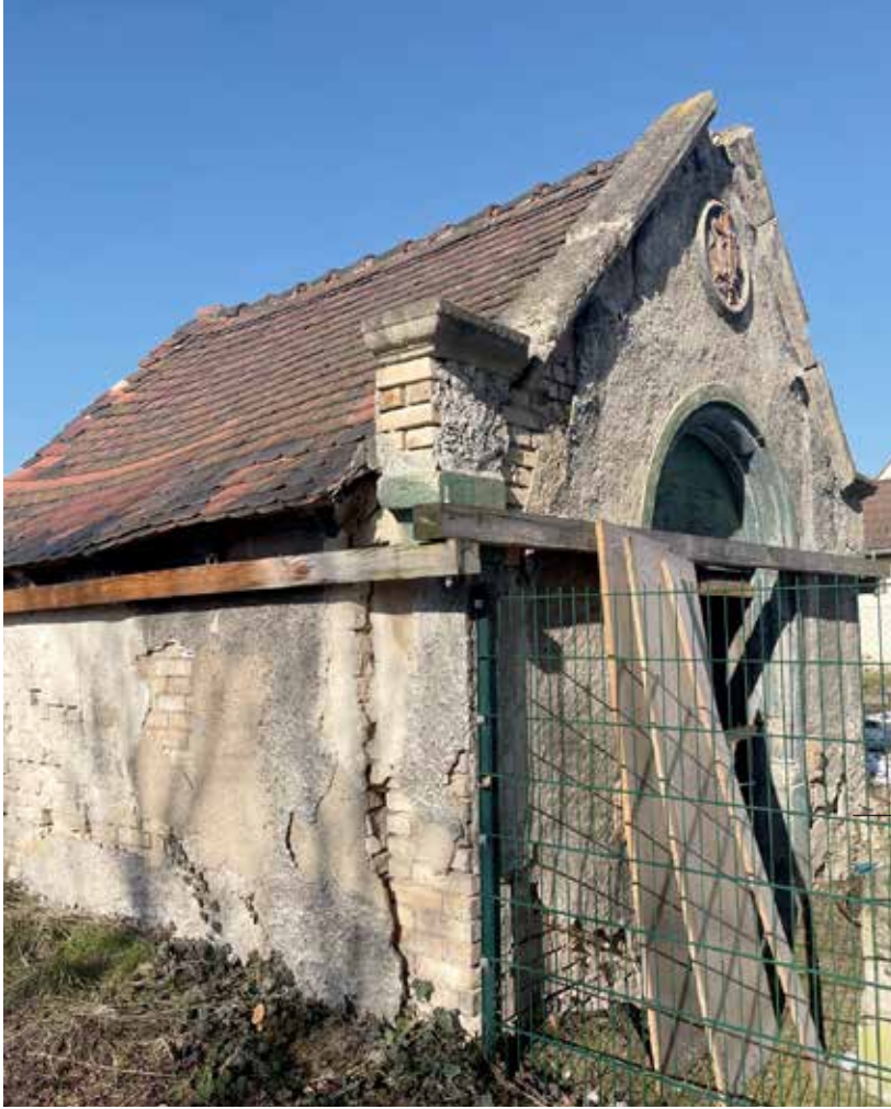
Sichtbare Spuren des Verfalls: Das Sinti-Mausoleum in Halle-Osendorf kann nun endlich gerettet werden. Die Gesamtkosten der Sanierung werden auf 350.000 Euro geschätzt.
